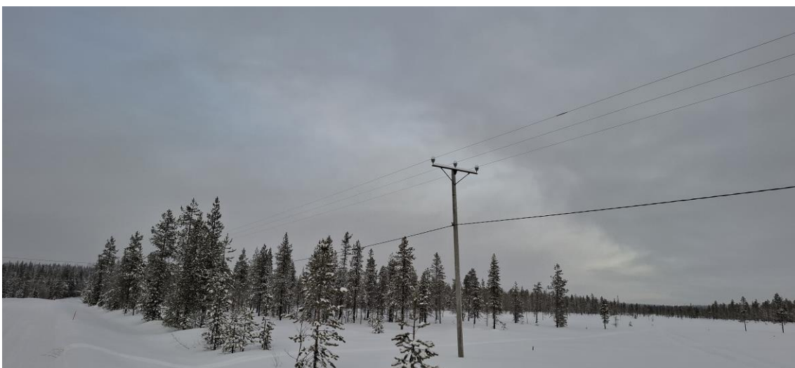
3. Suunnittelualueen lounaisosassa kulkee voimajohto tien laidassa. © J. Lokio 2/2025
